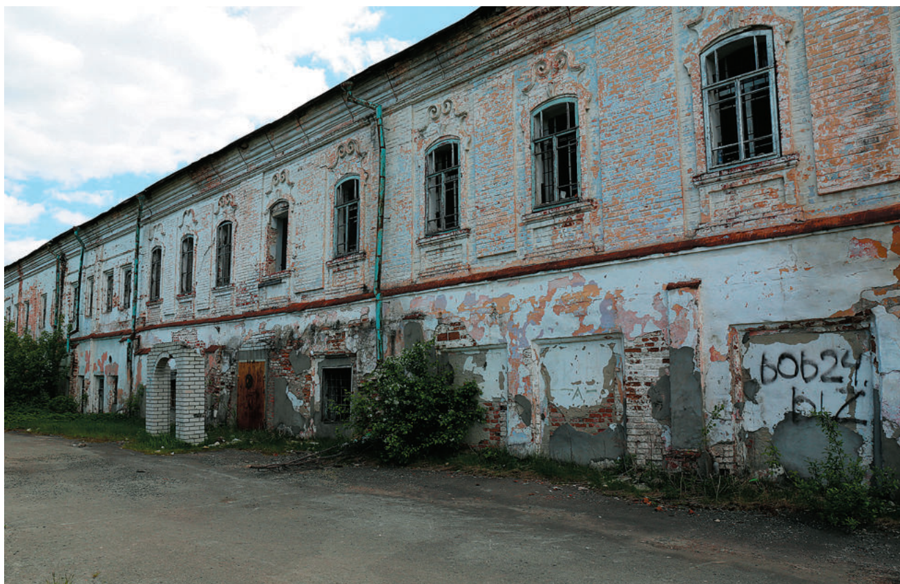
Знаменский монастырь (1623 г.). Объект – «Братско-настоятельский корпус с Казанской церковью» (1730-1768 гг.). г. Тобольск, ул. Декабристов, 21 /фото – 11.06.2017 г./
